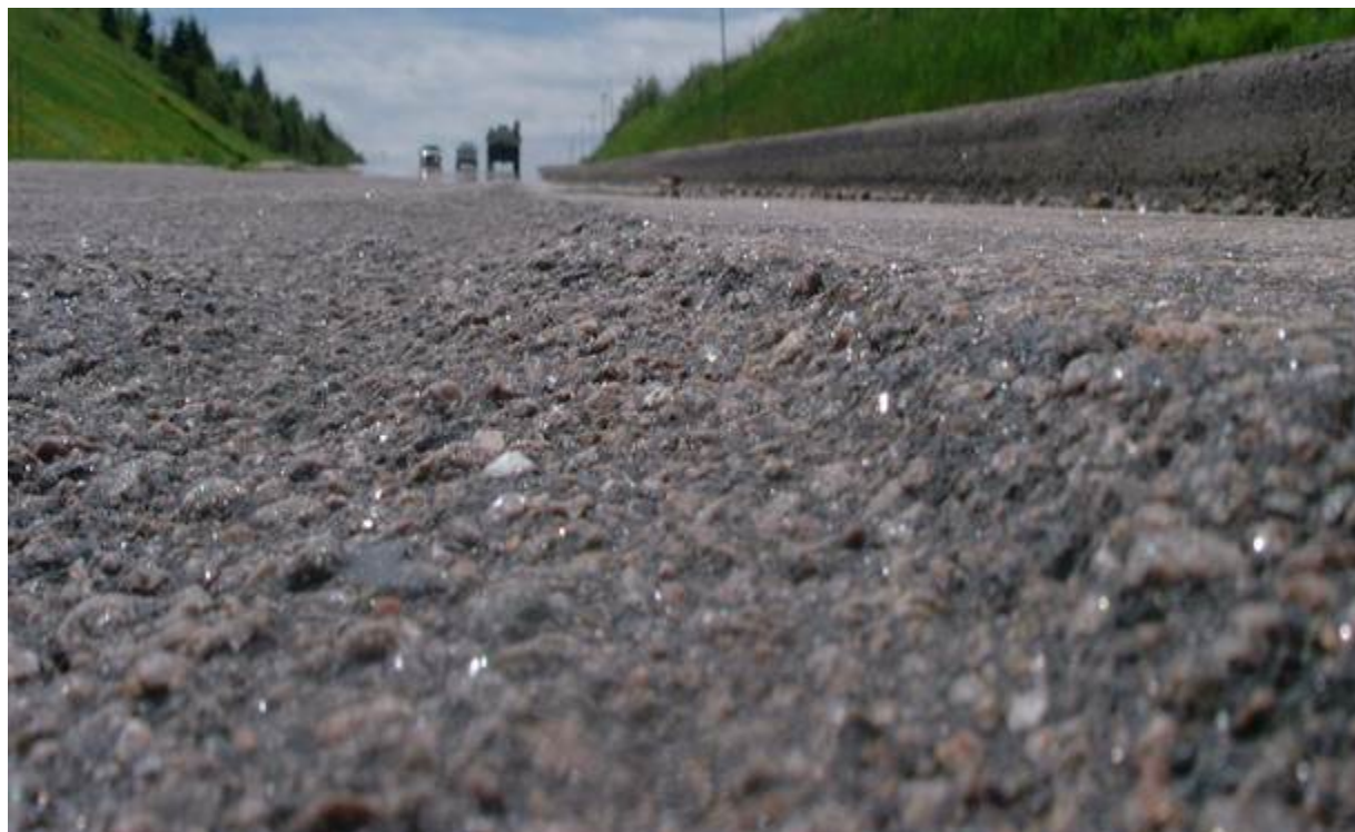
Figure 1. Exemple d'une chaussée où le phénomène de désenrobage est observé.
