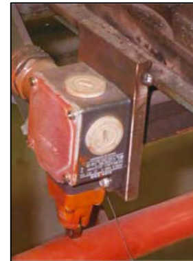
Protecteur désactivé (barrière abaissée)
