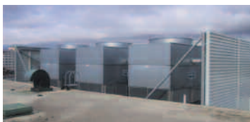
3.18 Tours de refroidissement
