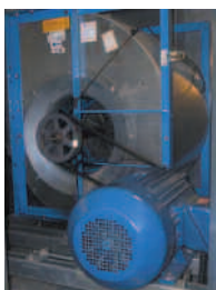
3.9 Ventilateur d'alimentation type centrifuge
