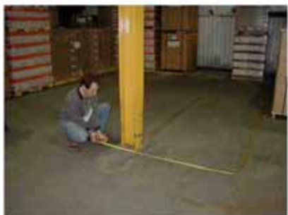
Figure 23 : Le bas de la colonne est déformé
