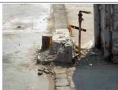
Éléments de structures et sols dégradés
