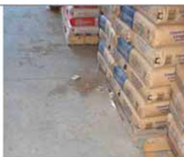
Substances poussiéreuses rendant le sol glissant
